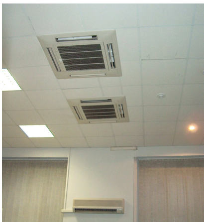
Рис. 2.1. Пример установки кондиционеров
