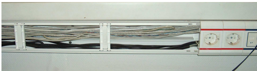
Рис. 2.2. Короб для укладки кабелей с открытой крышкой
